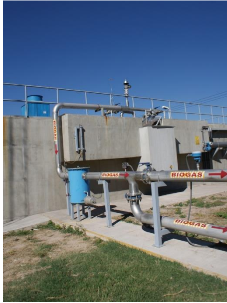
Línes for biogas
